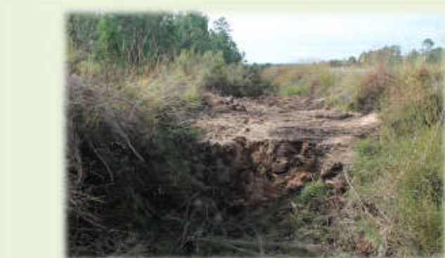
En bordure du pare feu, ce bouchon devra faire face à un afflux d'eau important. Ces seuils ont pour objectif de vérifier si le sable seul peut tenir avec des afflux importants, et s'il ne convient pas de le renforcer le cas échéant.
