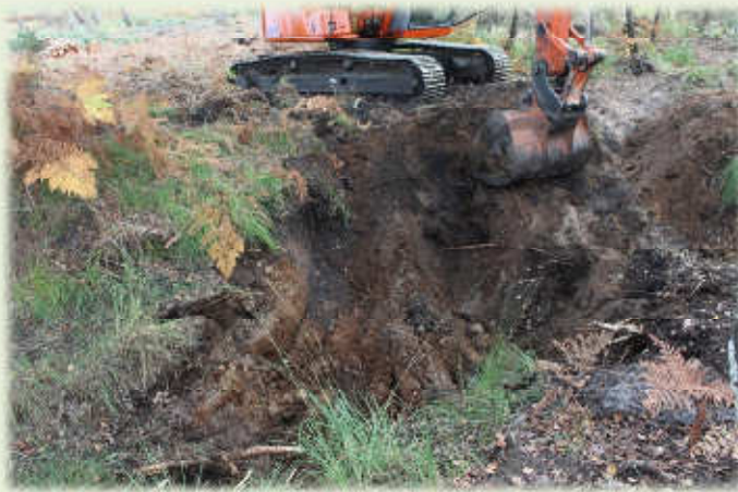
Creusement dans le fossé; les sables corresponaient parfaitement à des sols anciennement hydromorphes, mais drainés.
