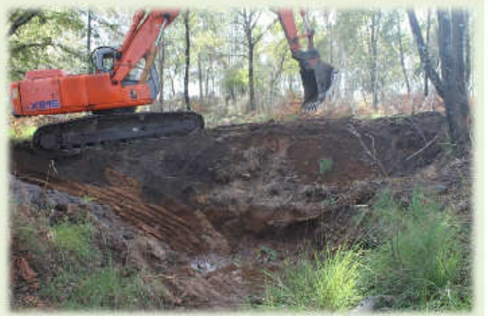
Les déblais constituent un barrage, qui servira également de passage. Compte tenu des débits à ce niveau, il est peu probable que les eaux passent sur le barrage. Ceci reste cependant à confirmer...
