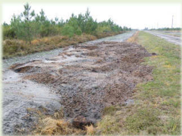
Premier essais de bouchons sableux dans les fossés. Des broyats ont parfois été apportés en sous-couche.
