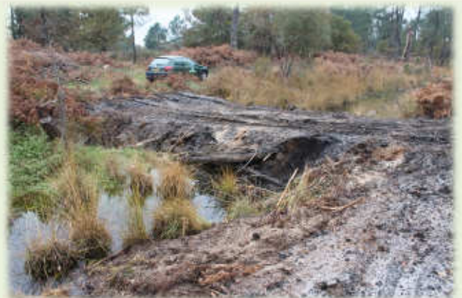
Même chose au niveau du canal nord, ici, en aval immédiat de la buse de sortie de l'étang. Du fait que dans cette partie le canal est à sec en été, il n'y a pas de contrainte de continuité écologique.
