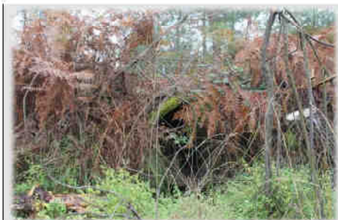
Point 22 : La buse (surdimensionnée) reliant l'étang au canal... On distingue à l'arrière le support du batardeau qui a été réalisé.
