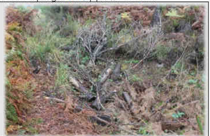
Point 18 : Depuis le même endroit, on peut voir le départ d'un fossé vers le nord ; il est partiellement encombré par des embâcles.
